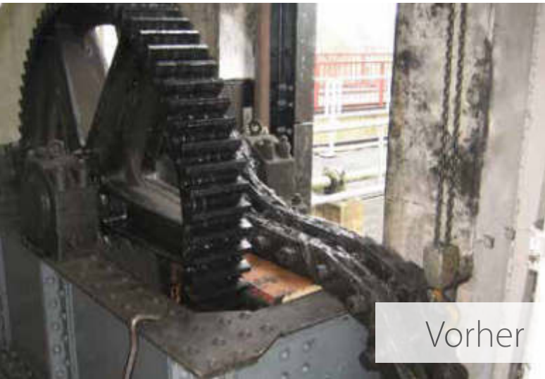
Kette vor Sperrvektor vor der Reparatur
